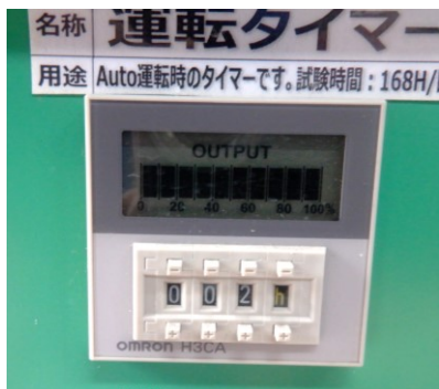
自動運転タイマー 2Hrで稼働
