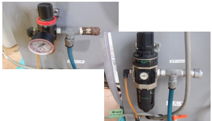
レギュレーター圧力調整不良、エアークプラの錆 交換
